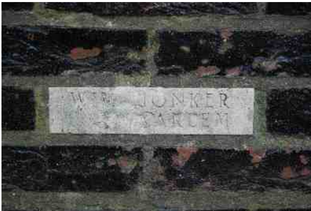
Veel bakstenen in het kunstwerk bij OBS de Krulder/SBO de Windvang vertonen schade van afsputtend glazuur
